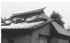
▲ 危険な空き家
