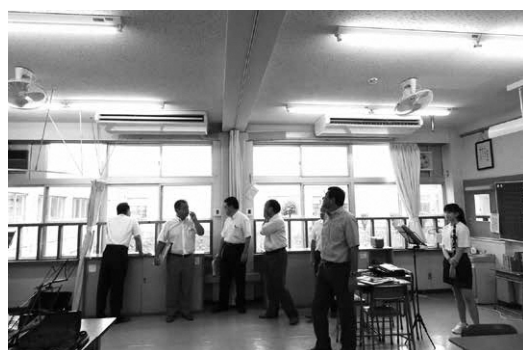
▲空調設備設置完了の音楽室
