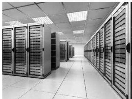
▲データセンターの例
