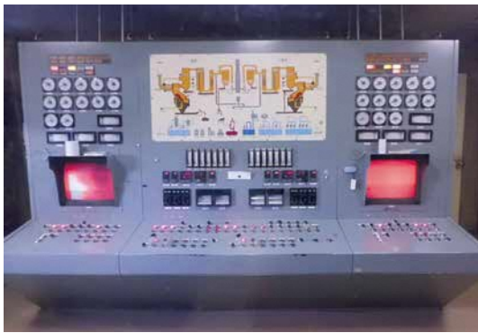
▲ 清掃センター中央操作室
