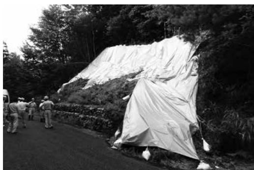
▲林道今滝冬鳥越線の法面崩壊
