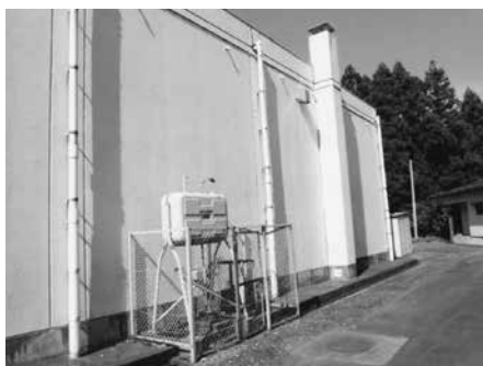
▲田上小学校 排気用煙突
