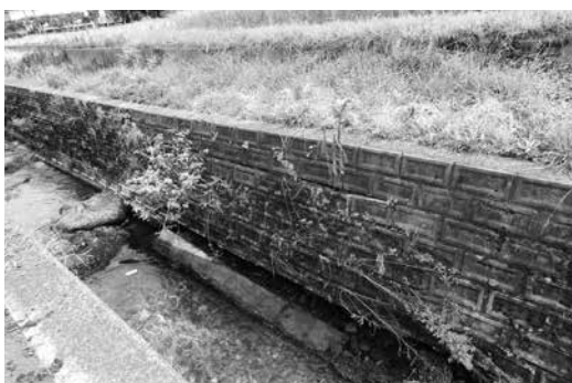
▲危険な状況の羽生田川の護岸破損
