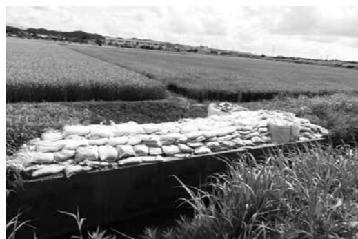
▲茗ヶ谷川洗掘状況
