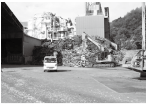
▲木質燃料置場
