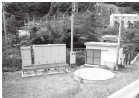
▲小水力発電所 全景
