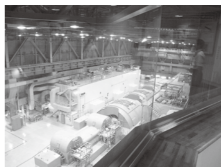
▲柏崎刈羽原子力発電所
