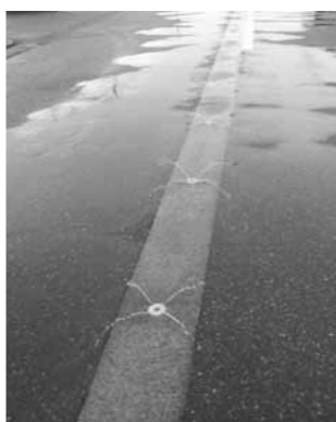
▲点検中の消雪パイプ
