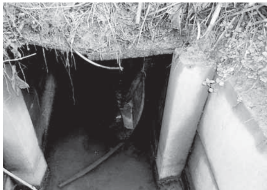
▲逆流防止弁(フラップゲート)
