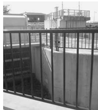
▲新大正川排水機場
