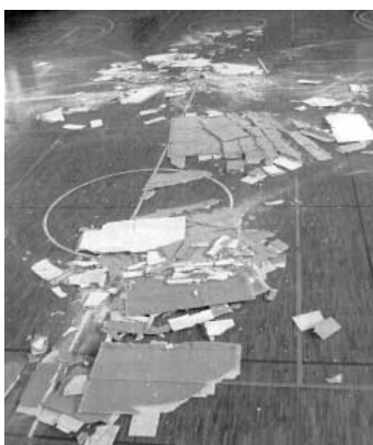
中学校体育館の天井から落下した一面のボード
