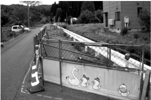
羽生田川の陥没現場
